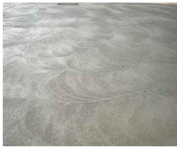
P-02 Formigó remolinat.
