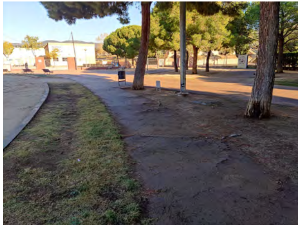
Mal estat del camí pavimentat de l'entorn
