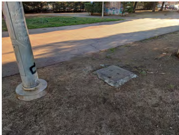
Arqueta existent de l'enllumenat públic
