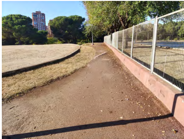
Paviment existent en mal estat
