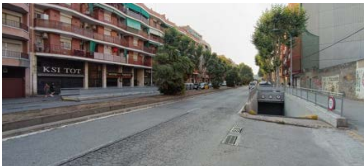
Estat de la calçada general de l'avinguda Joan XXIII
