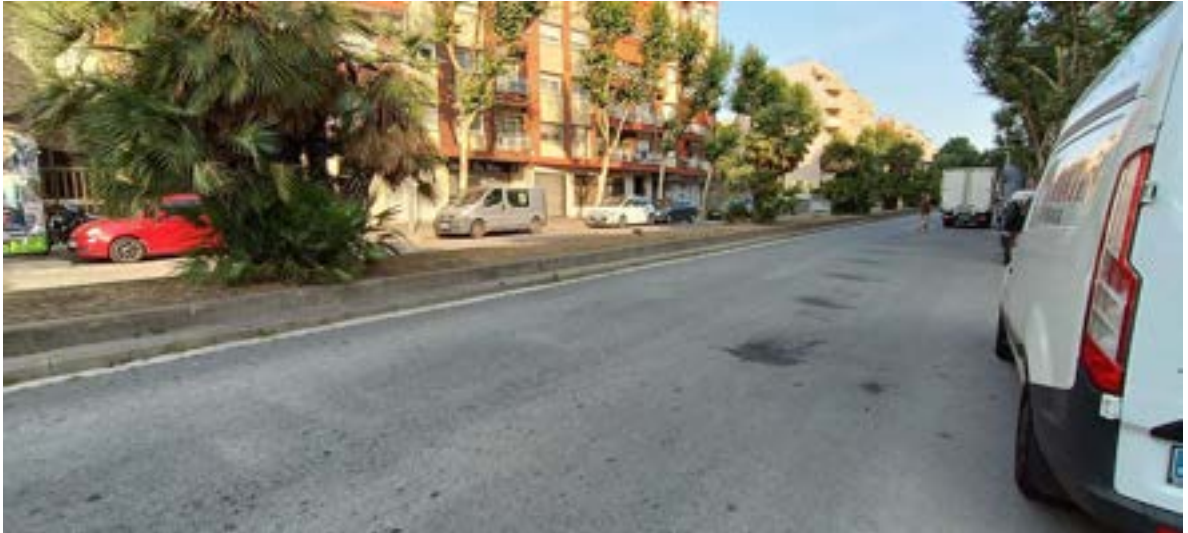
Costat sentit Av\ Alfons XIII – Vistes generals estat del ferm.
