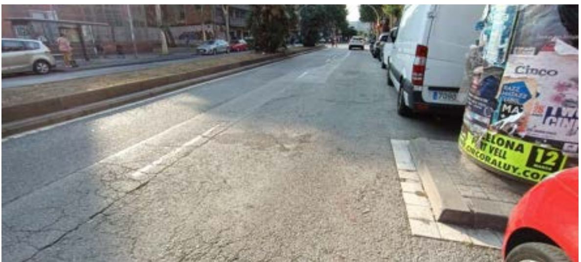
Estat del ferm en zona estretament calçada per conducte ventilació aparcament.
