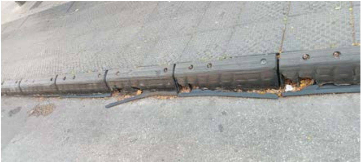
Plataforma modular d'accessibilitat a bus. Peces de vorada malmeses a substituir per peces noves.
