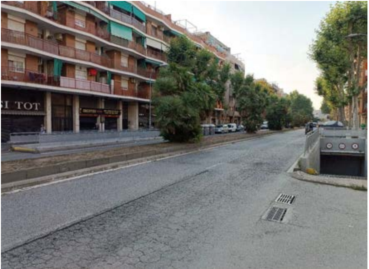
Costat sentit St. Adrià - Estat del ferm zona prèvia rampa aparcament
