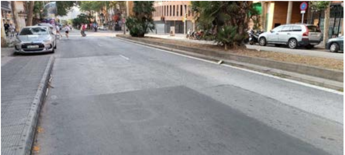
Costat sentit Avl Alfons XIII – Vistes general estat del ferm davant parada bus.
