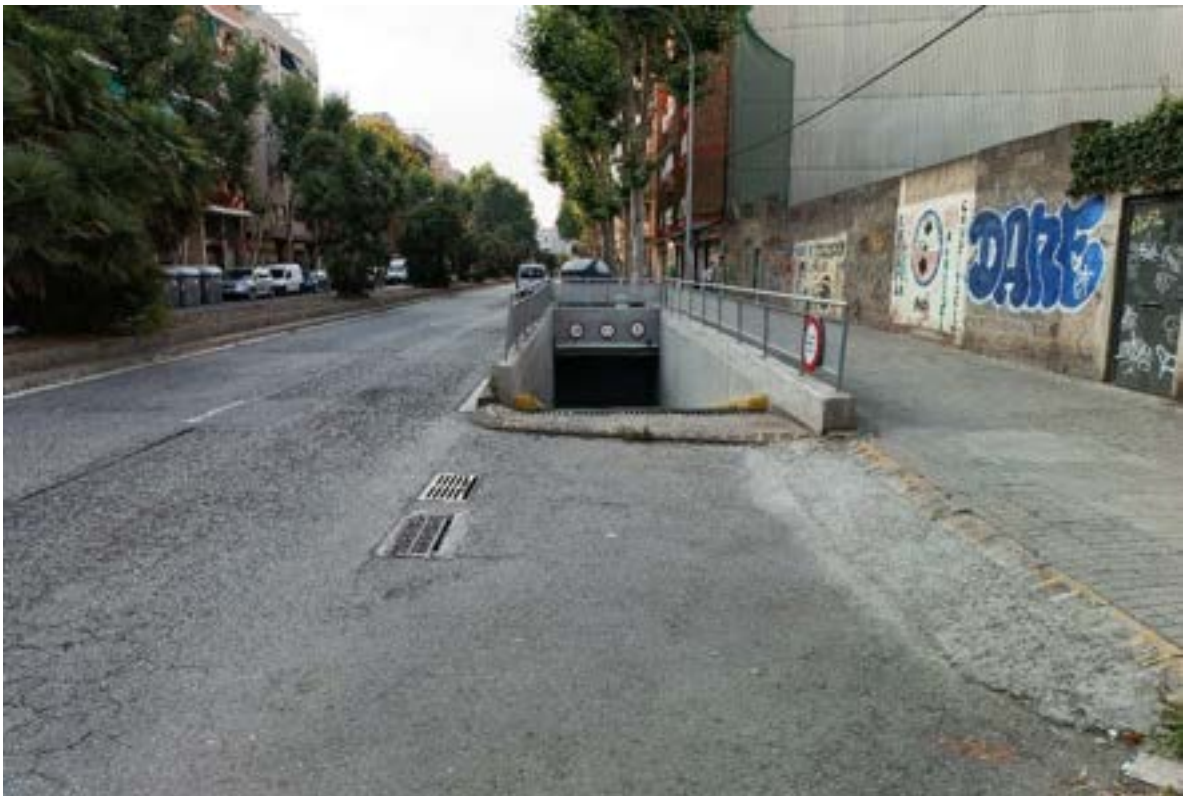
Ampliació calçada en zona prèvia a rampa aparcament. Recrescut formigó gual a repicar.
