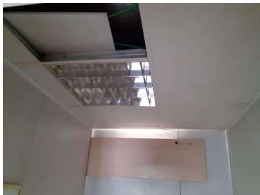
Sostre i llumenera vandalitzat .
