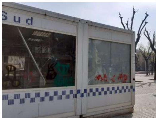
Façana amb vidres malmesos.
