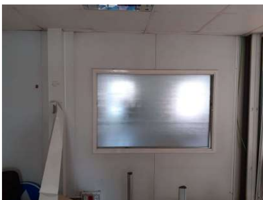
Finestra vandalitzada protegida.
