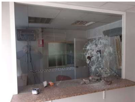
Vidre trencat recepció.
