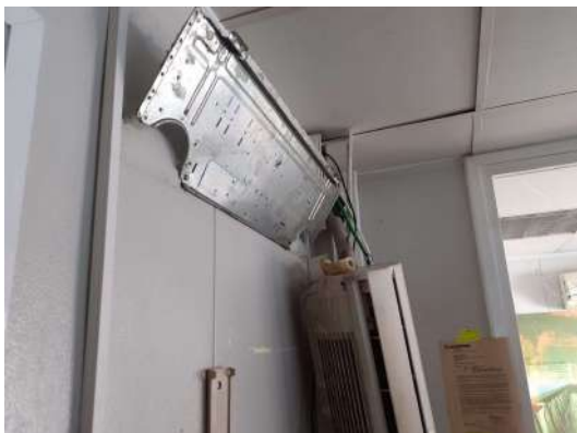
Aparell climatització vandalitzat.
