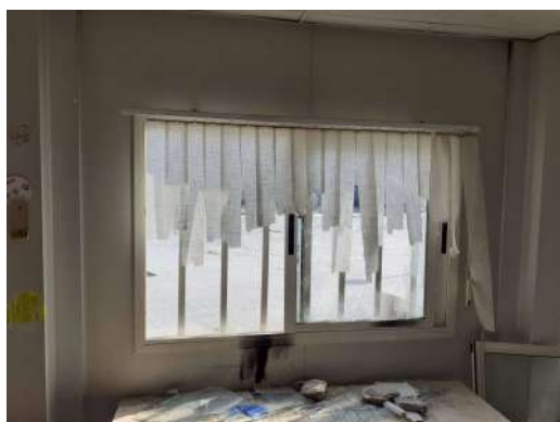
Cortina horitzontal destrozada.
