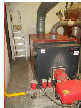
FOTO 1 CALDERA EXISTENT ROCA PR40/2G
