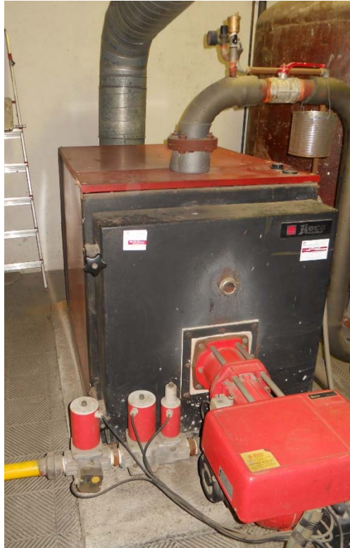
Fotografia 1. Caldera ROCA NTD-260
