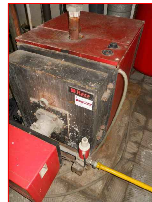
FOTO 2 CALDERA EXISTENT ROCA PR18-G
