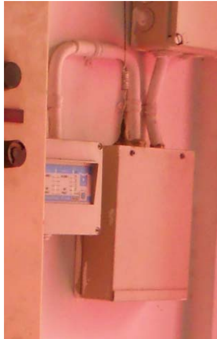
Fotografia 6. Sistema detecció de gas
