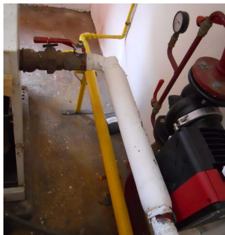
Fotografia 4. Bomba impulsió calefacció
