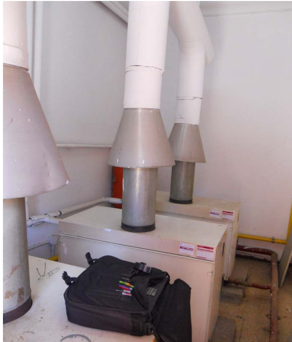
Fotografia 1. Calderes ROCA GC-90
