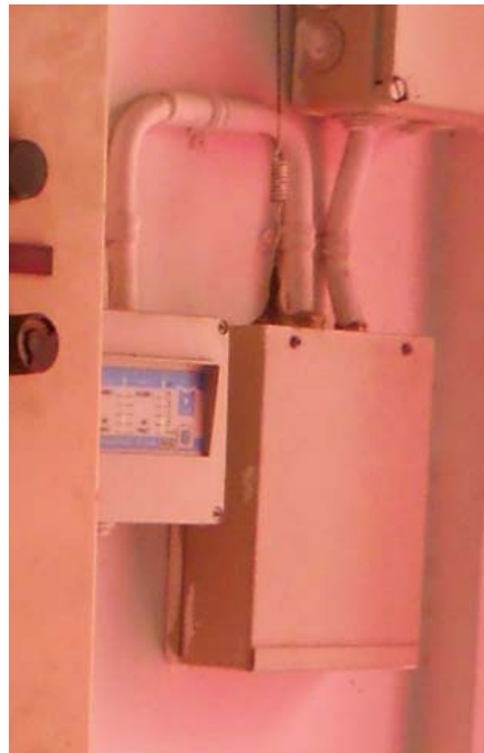
Sistema detecció de gas
