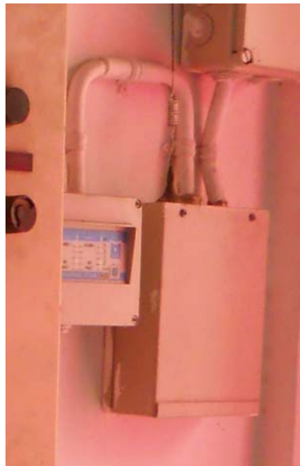
Sistema detecció de gas
