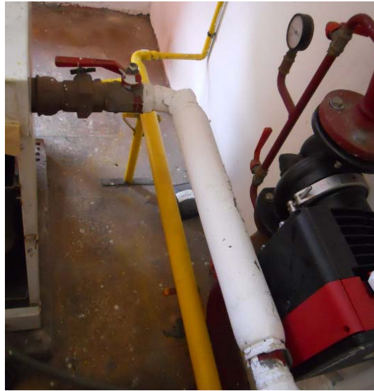
Bomba impulsió calefacció
