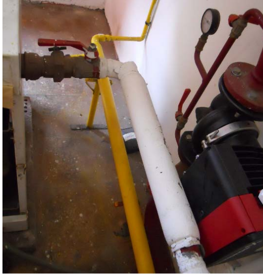
Bomba impulsió calefacció
