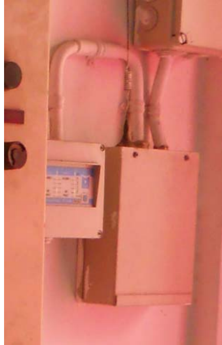
Fotografia 5. Sistema detecció de gas
