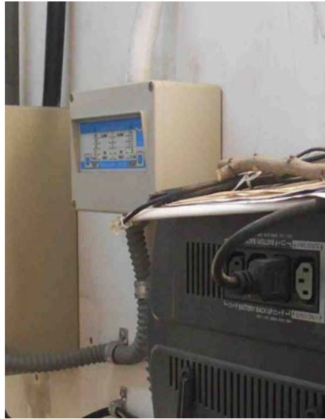
Sistema de detecció de gas
