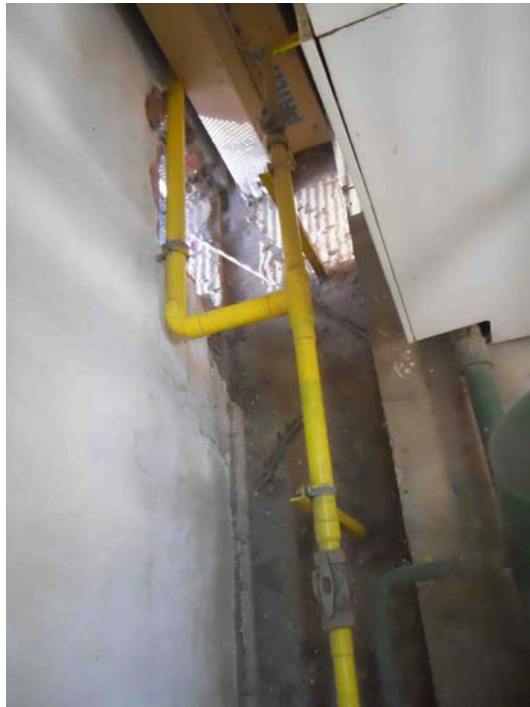
Alimentació de gas a les calderes
