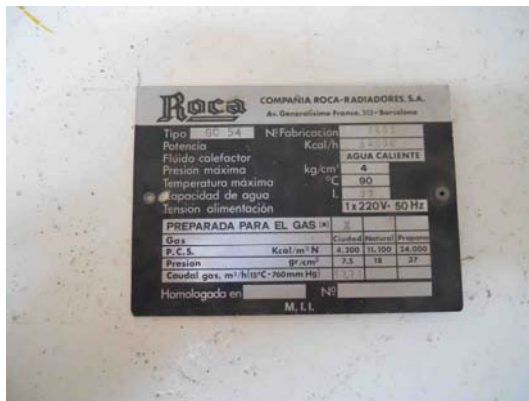
Placa d'una de les calderes
