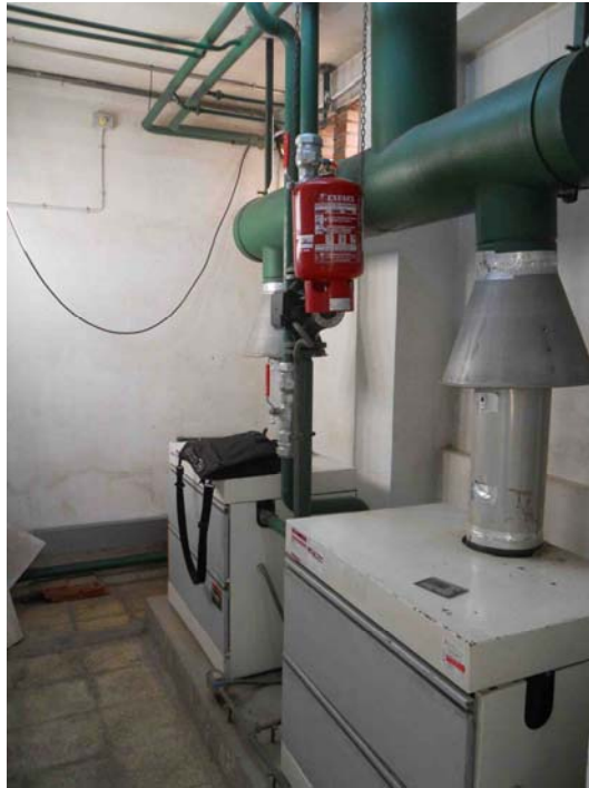
Sala de calderes
