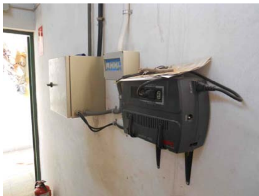
Sistema de detecció de gas i quadre elèctric
