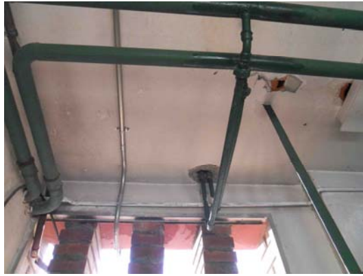
Ventilació de la sala
