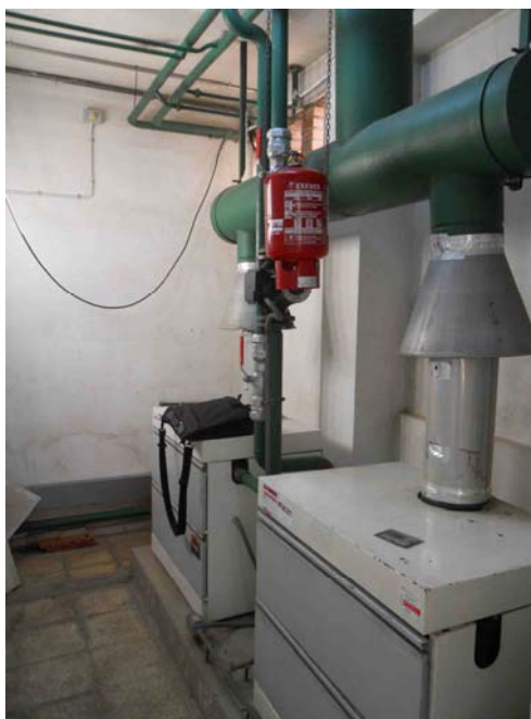
Sala de calderes
