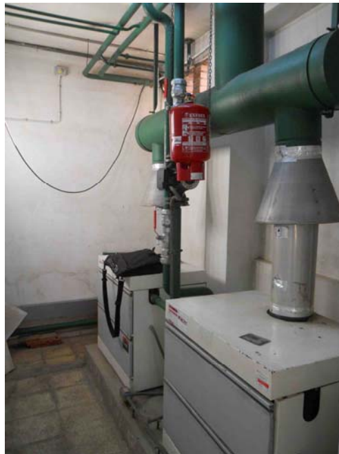
Sala de calderes
