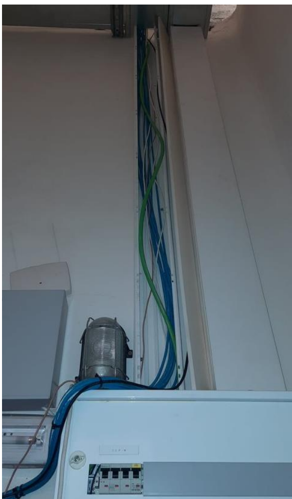
Imatge 1 – canalització sense tapa, cablejat sense canalitzar, lluminària que no funciona
