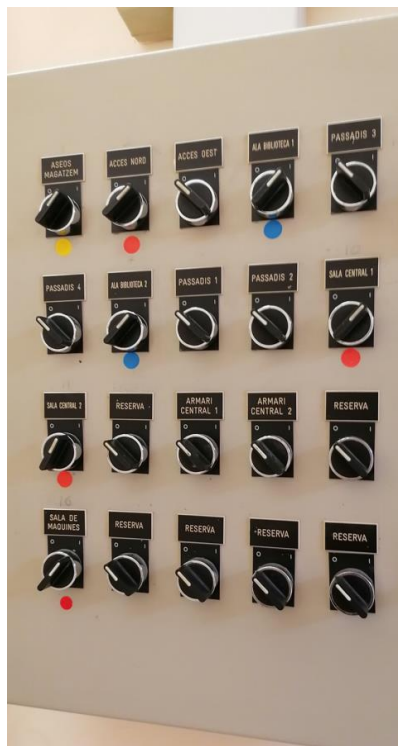
Imatge 6 – centralització de pulsadors
