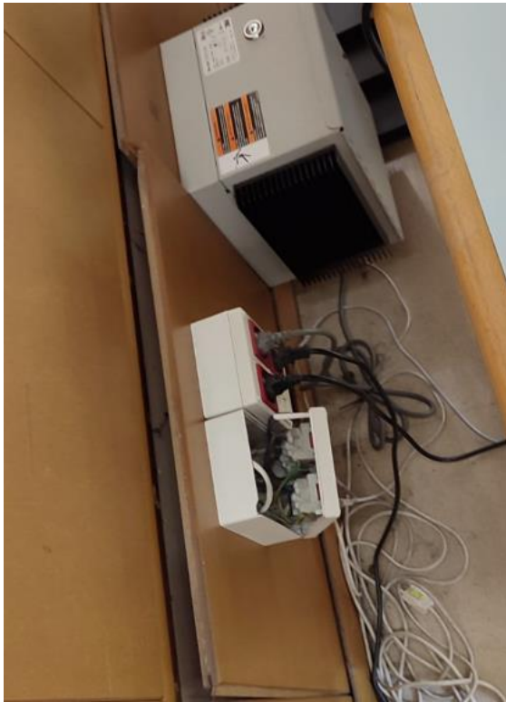
Imatge 8 – endolls en mal estat
