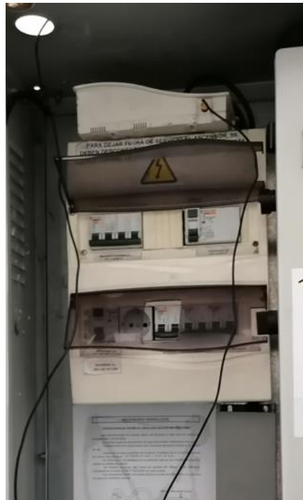
Imatge 5 - Quadre ascensor
