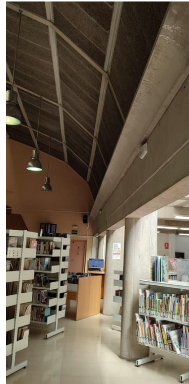
Imatge 9 – enllumenat general en mal estat
