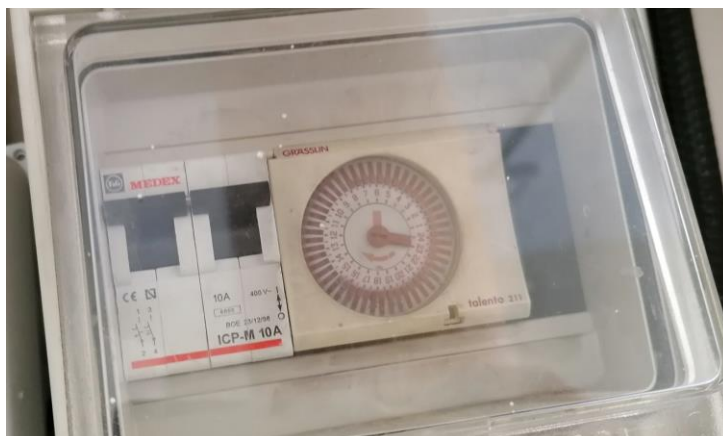
Imatge 2 – petit quadre elèctric dins del armari de la TMF1, amb protecció magnetotèrmica tipus ICPM
