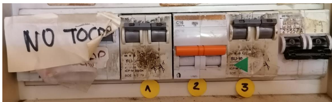
Imatge 5 – proteccions magnetotèrmiques a canviar al quadre general
