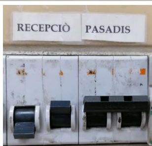
Imatge 10 – proteccions trencades o amb les característiques esborrades
