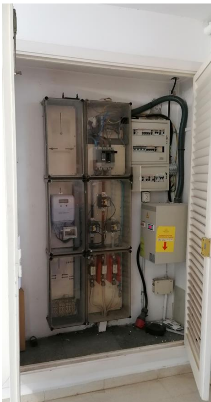
Imatge 1- TMF10 i quadre elèctric
