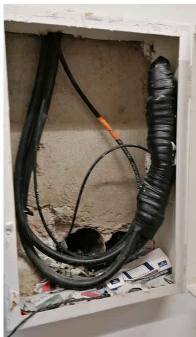
Imatge 11 – armari antiga CGP, per on es produeixen infiltracions d'aigua.
