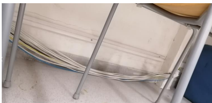
Imatge 3 – cablejat mal canalitzat
