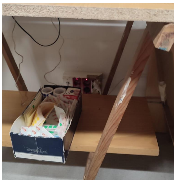
Imatge 2 – endolls en mal estat
