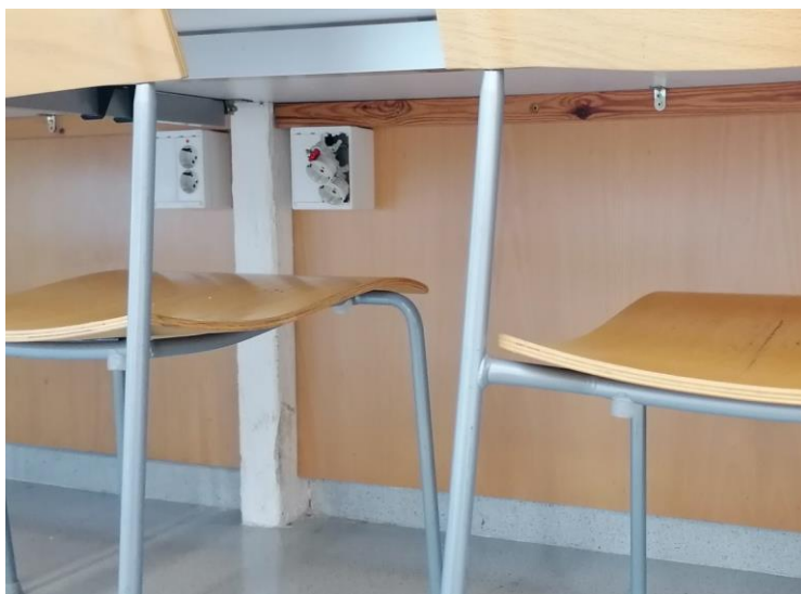
Imatge 1 – endolls en mal estat
