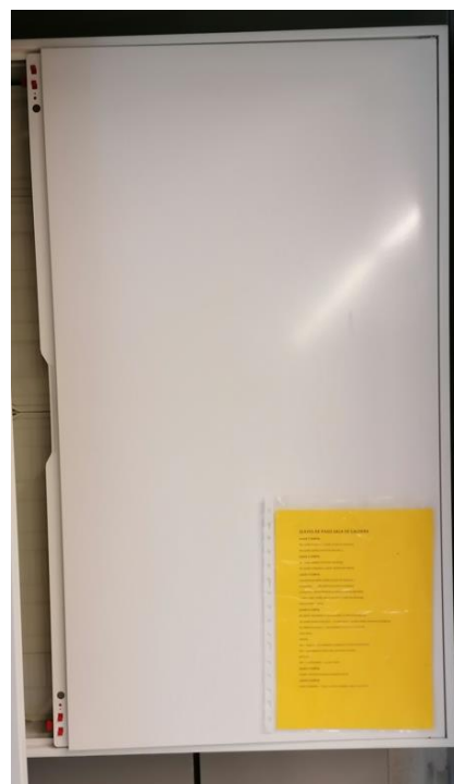
Imatge 2 – quadre elèctric porta dreta
