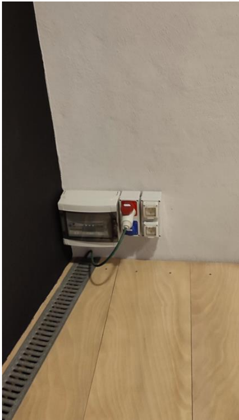
Imatge 9 – centralització endolls amb proteccions
