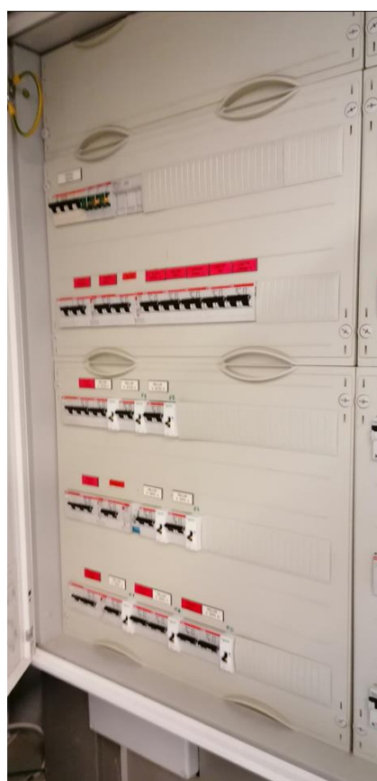
Imatge 3 – quadre elèctric part esquerra
