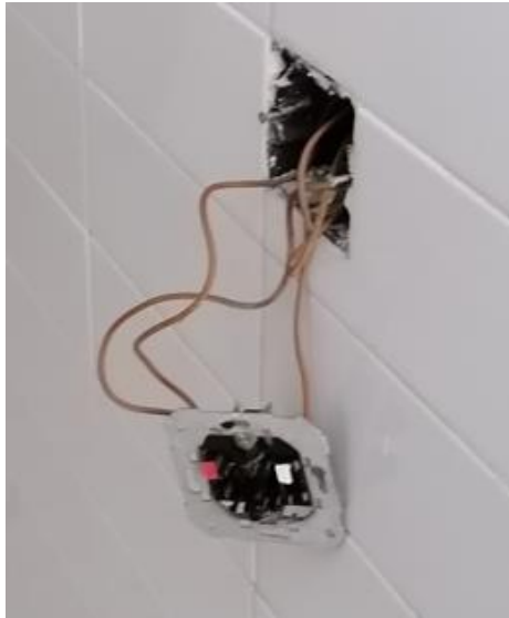
Imatge 9 – interruptor sense tapa i penjant
