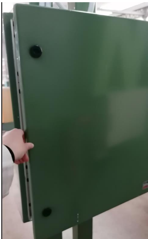
Imatge 18 – Quadre elèctric per fora
