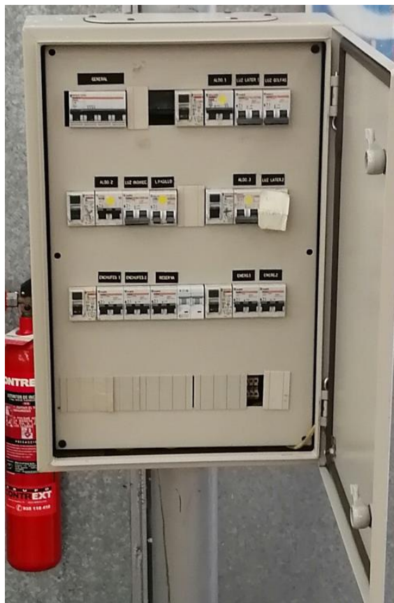
Imatge 21 – Quadre elèctric
