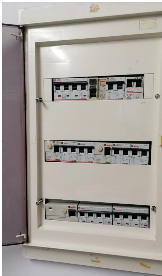
Imatge 17 – Quadre elèctric
