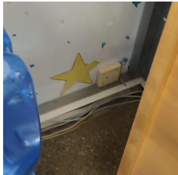
Imatge 8 – canalització oberta sense tapa
