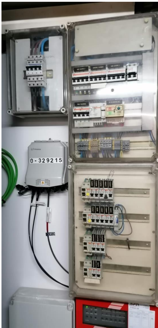
Imatge 13 - Quadre elèctric General Zona antiga
