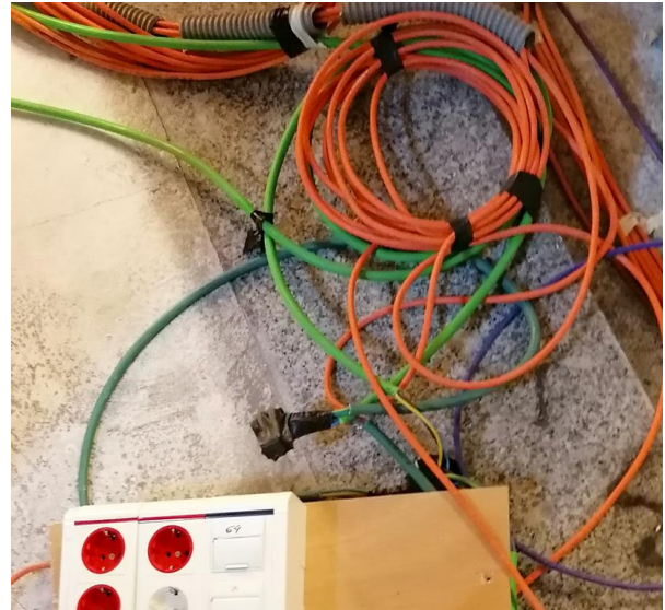
Imatge 10 – cablejat sense canalitzar i amb connexions encintades fora de caixetins
