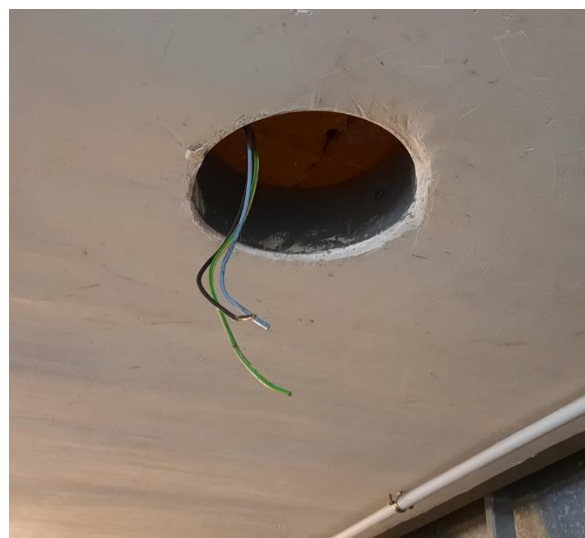
Imatge 16 - Cables en punta
