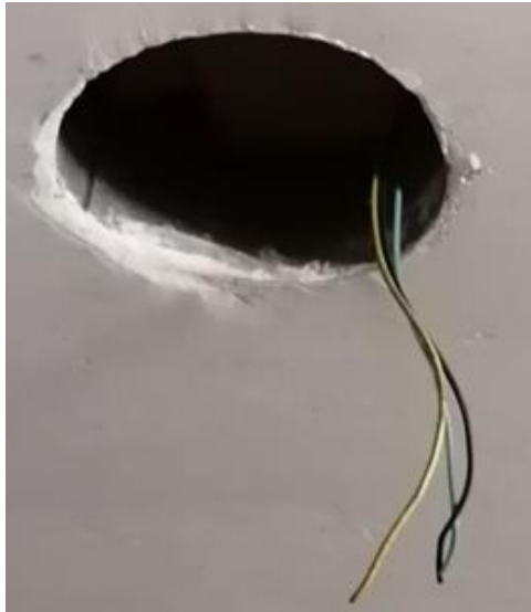
Imatge 1 – exemple cables en punta
