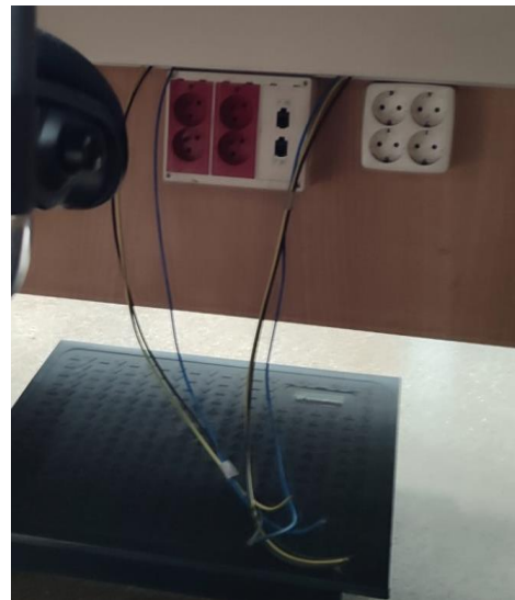
Imatge 4– exemple cables en punta
