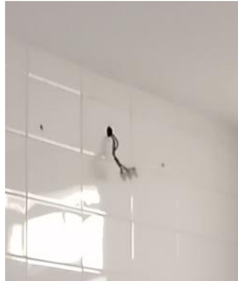
Imatge 2 – exemple cables en punta
