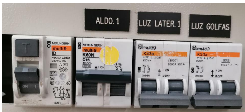
Imatge 22 – Diferencial que no funciona
