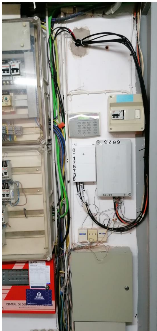
Imatge 14 - Canalitzacions en mal estat: canals sense tapa, cablejat sense canalitzar
