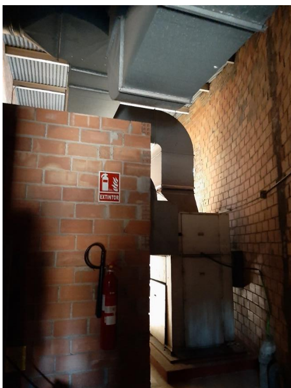
Fotografia 3. Unitat a canviar. Interior sala tècnica.
