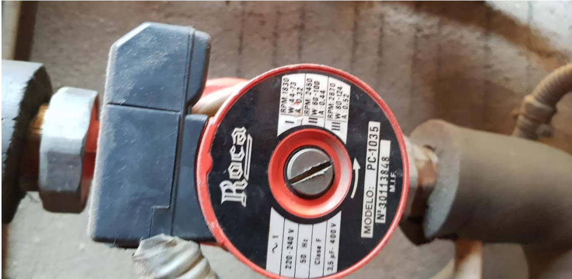
Annex 11.1.4. Bomba de circulació circuit sud
