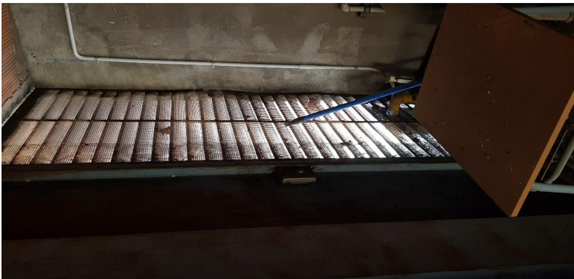
11.1.12. Reixa de ventilació
