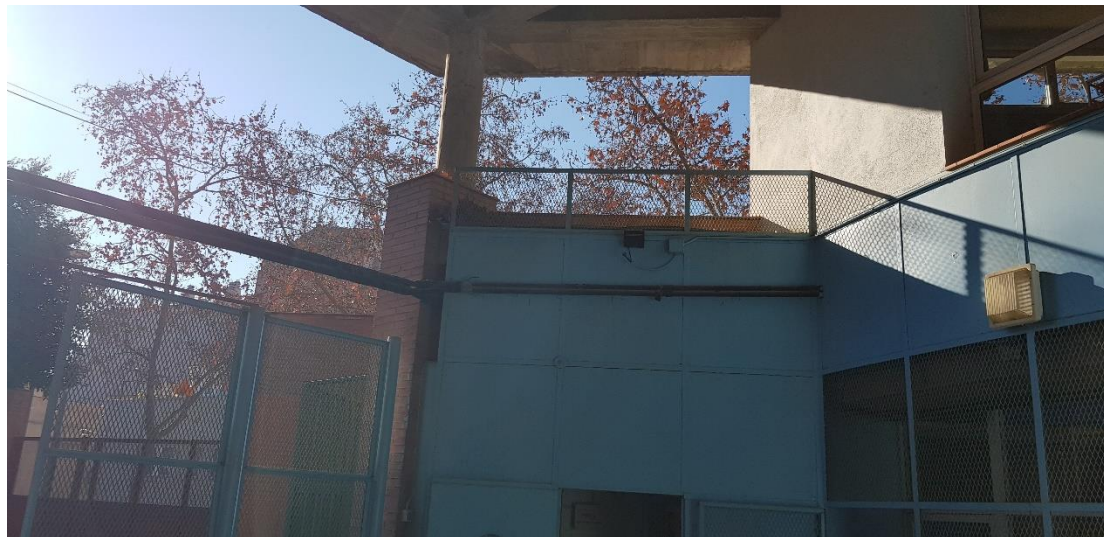
Figura 7. Tubs amb aïllament en mal estat
