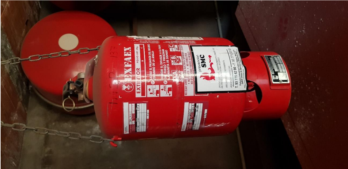
11.1.13. Extintor interior de la sala
