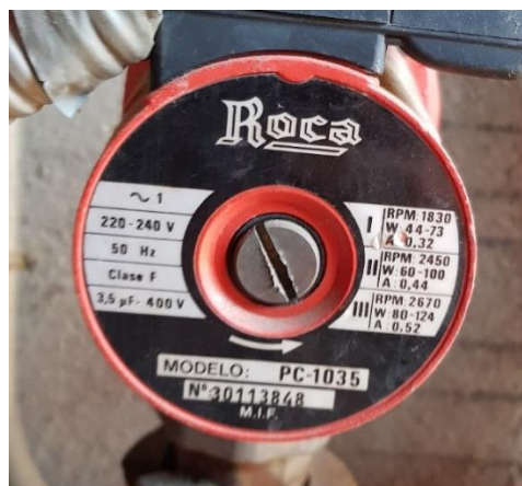
Figura 9. Bomba de circulació actual
