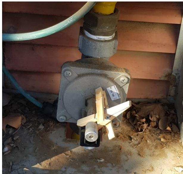
Figura 5. Electrovàlvula de tall de gas existent
