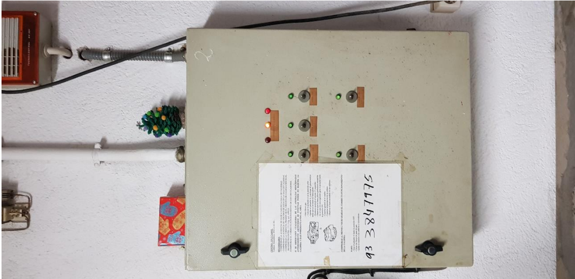
11.1.10. Cartell d'indicacions de la sala de calderes
