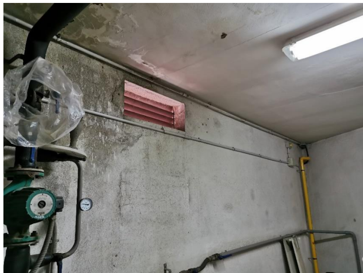
11.1.12. Reixa de ventilació
