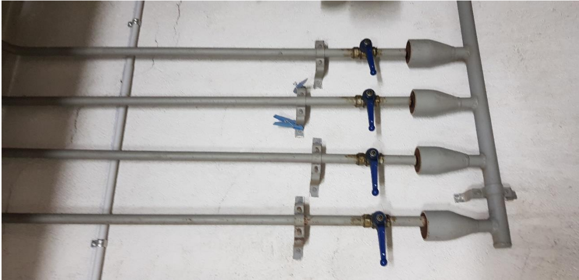
11.1.13. Evacuació d'aigua del sistema
