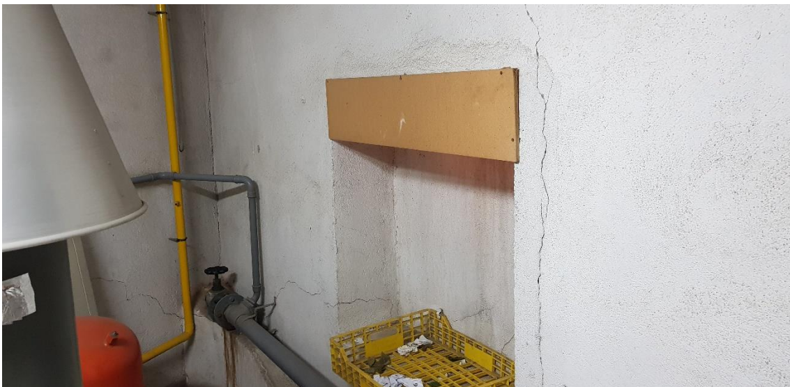
11.1.18. Paret dèbil existent
