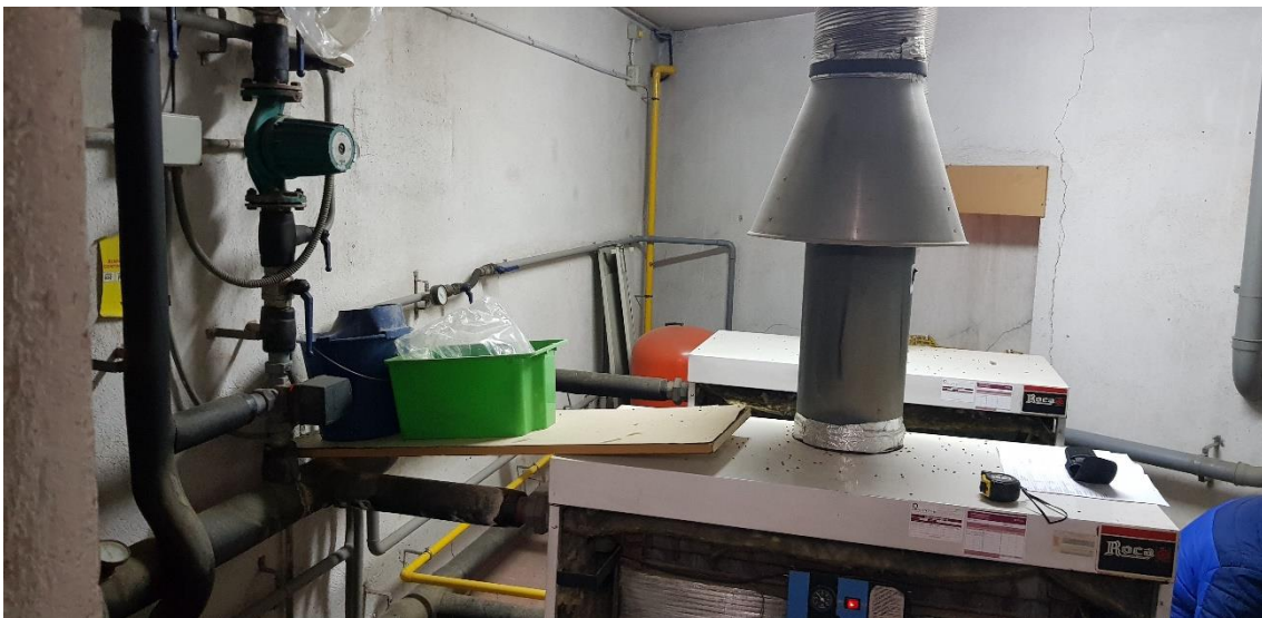
Annex 11.1.8. Sala de calderes
