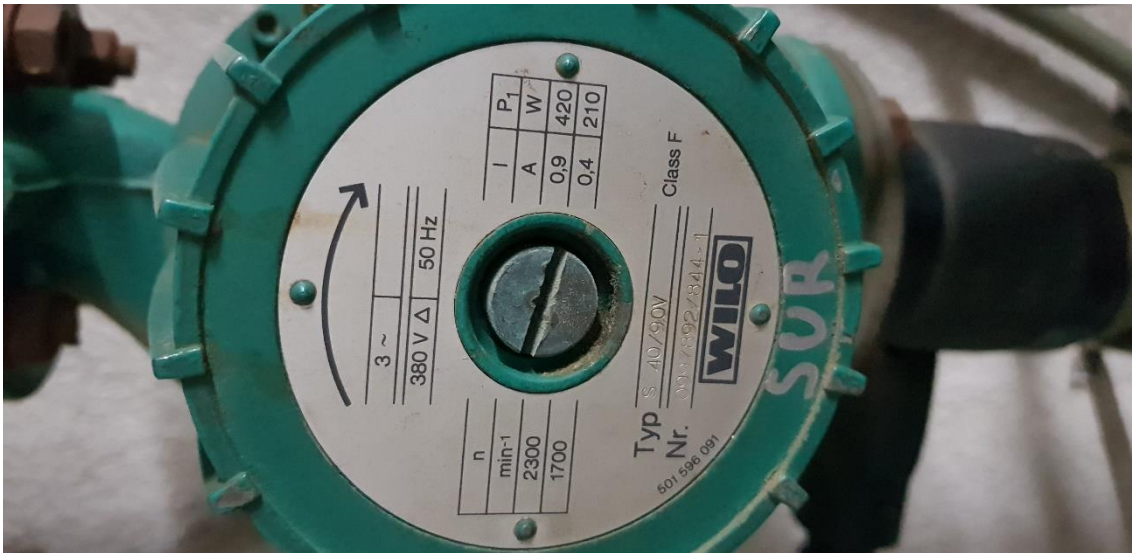
Annex 11.1.4. Bomba de circulació circuit sud
