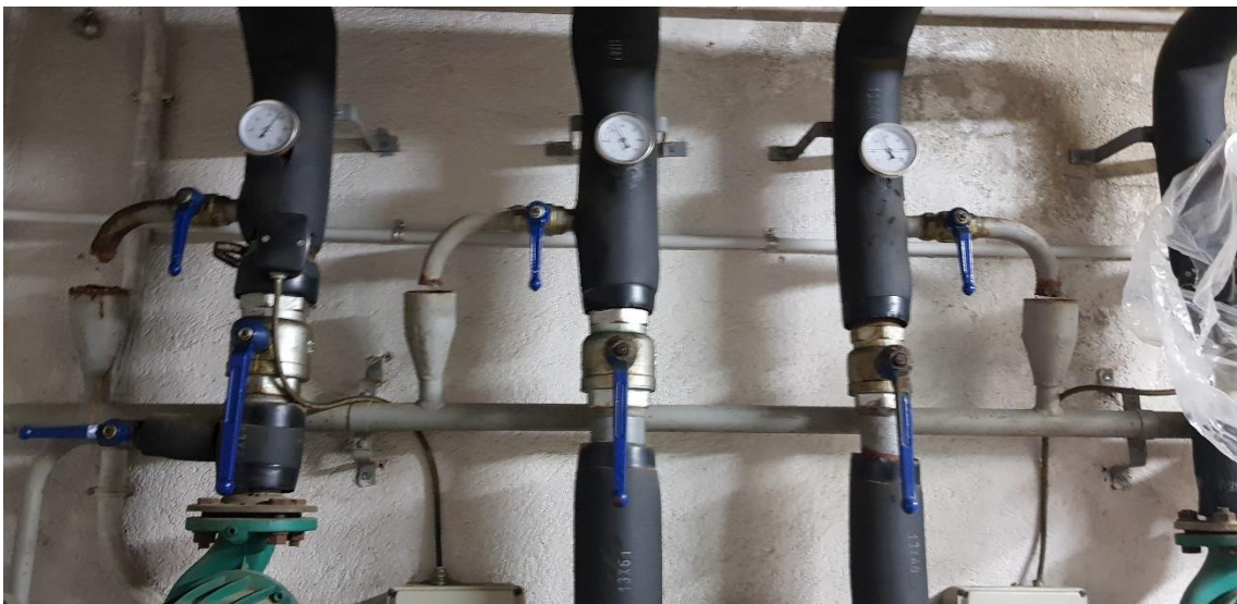
11.1.14. Tubs amb aïllament del circuit tèrmic, valvuleria i termòmetres
