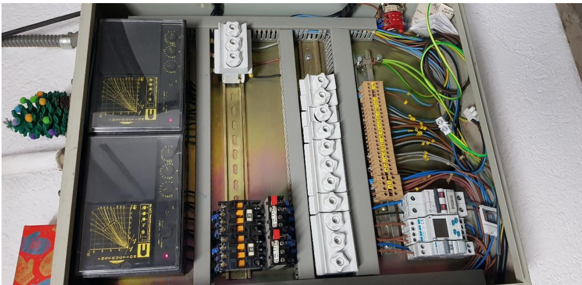
11.1.11. Quadre elèctric i de control
