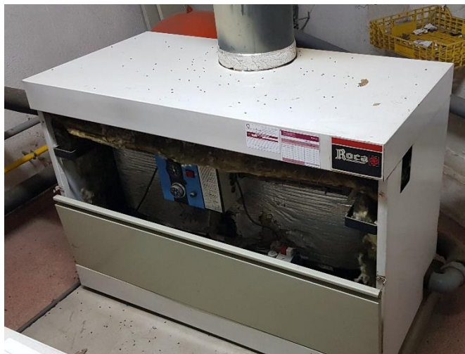
Figura 1. Calderes de la instal·lació existent
