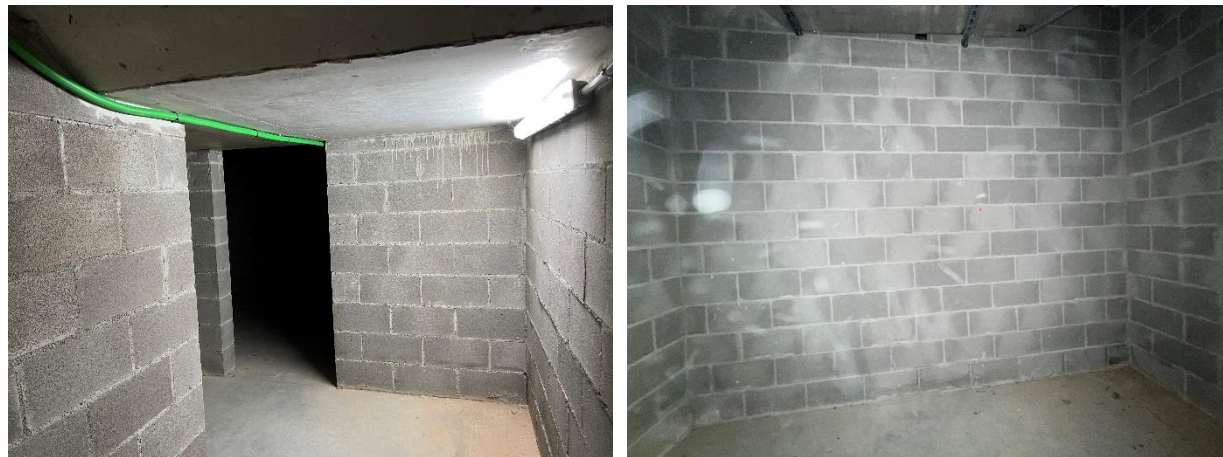
Figura 9. Sala Muntant d'Instal·lacions
