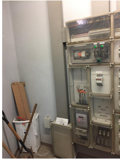
Espai on instal·lar comptador energia neta
