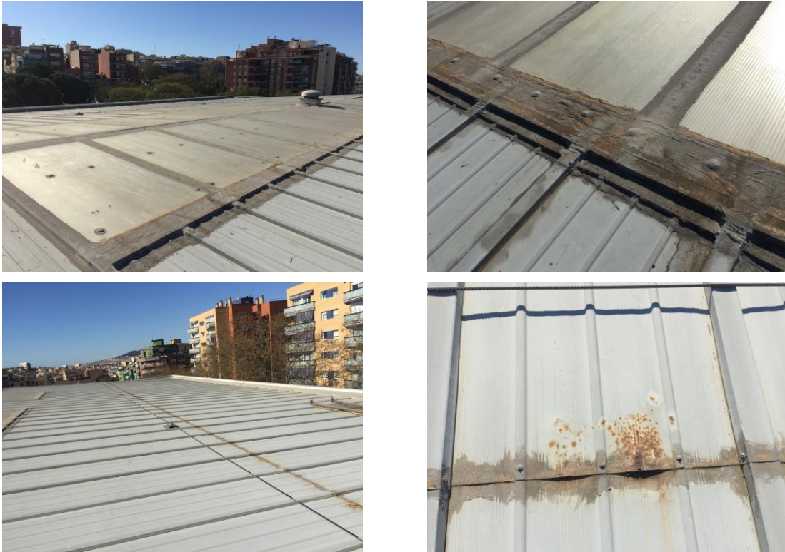
Figura 4. Deficiències impermeabilització coberta
