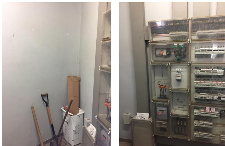
Figura 15. Sala de baixa tensió
