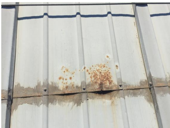
Juntes planxes Sandwich a reparar
