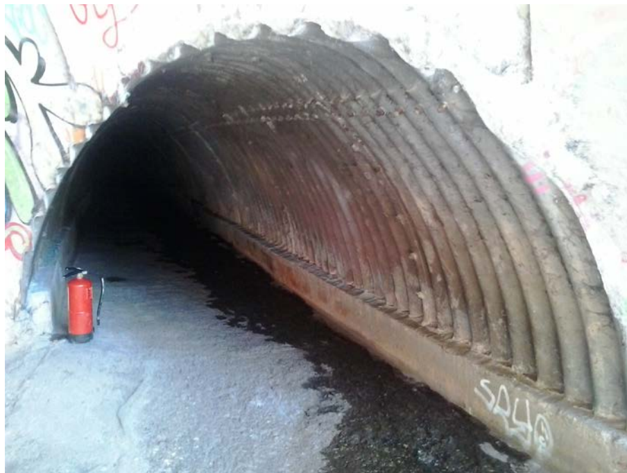
Canonada de desguàs de la riera de Montalegre dins l'obra de fàbrica sota l'Av. de la Cerdanya
