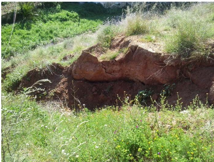
Erosió local per la infiltració d'aigua al talús superior
