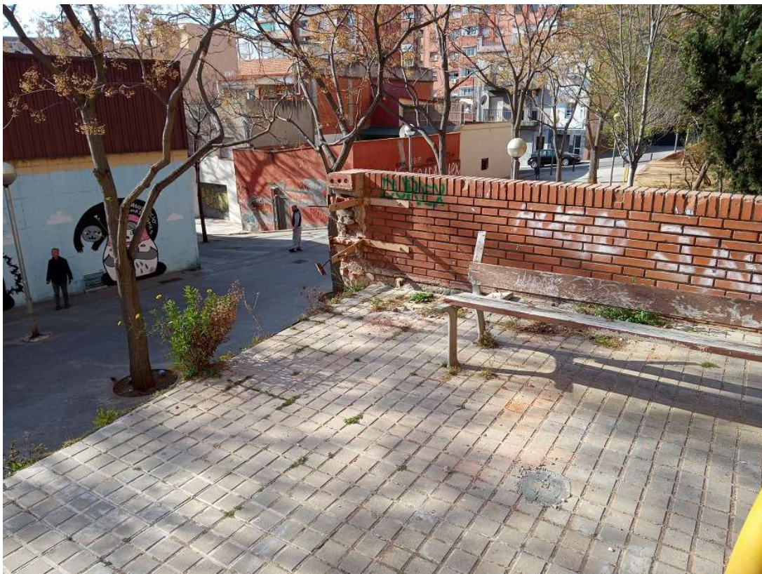
Fotografia n°6: Desnivell sense protecció al c/ Venezuela.
