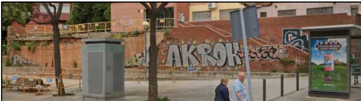
Vista general del mur de contenció revestit amb maons, amb una zona d'escaleres en direcció a l'avinguda del Doctor Bassols. El tram afectat pel despreniment del revestiment de moment correspon al sector de l'esquerra.
