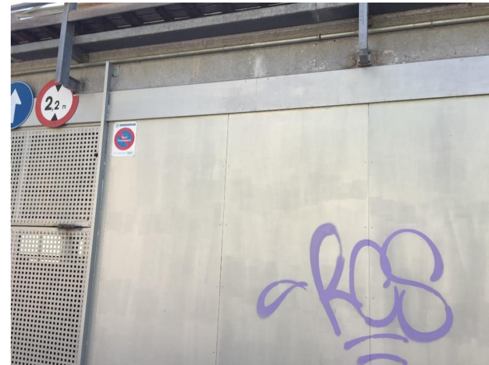
Tancament Sala Rack, on s'hi instal·laran porticons per fer la lectura del comptador d'energia neta
