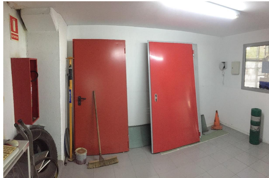
Sala Rack Aparcament Privat que es rehabilitarà per col·locar-hi l'inversor i el comptador d'energia neta
