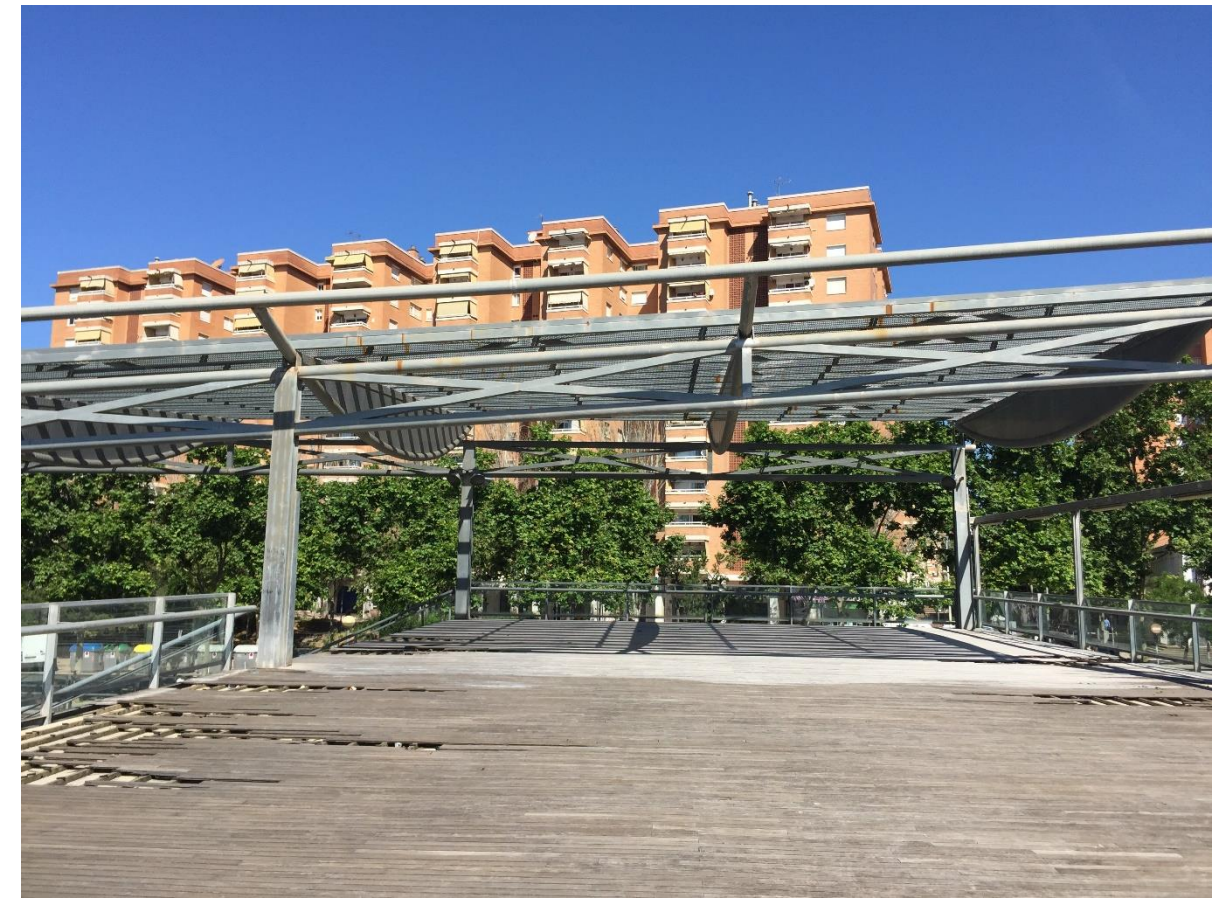
Pilar de l'estructura de la Pèrgola on s'instal·larà l'escala vertical fixa de manteniment
