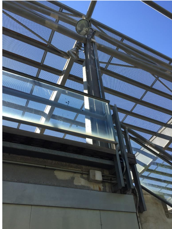
Pilar de l'estructura de la Pèrgola per on baixaran les canalitzacions de continua fins a la sala rack
