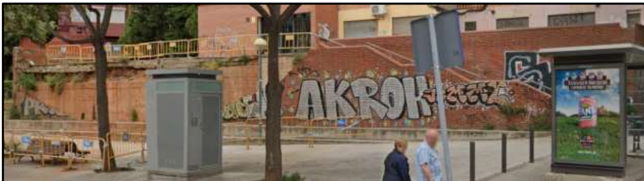
Vista general del mur de contenció revestit amb maons, amb una zona d'escaleres en direcció a l'avinguda del Doctor Bassols. El tram afectat pel despreniment del revestiment de moment correspon al sector de l'esquerra.
