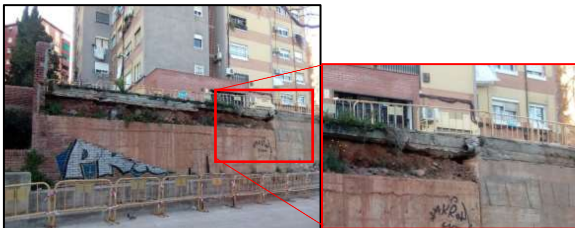
Diferents vistes generals i de detall de la canal de recollida d'aigües trencada.
