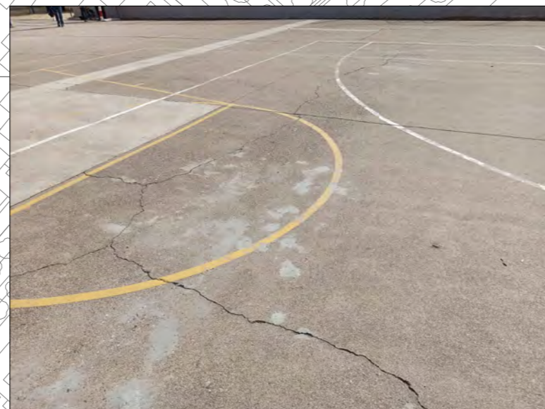
Foto 6: Patologies Paviment Pistes
