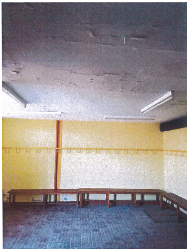
Vista general de l'interior dels vestidors on es veu l'estat del sostre.
