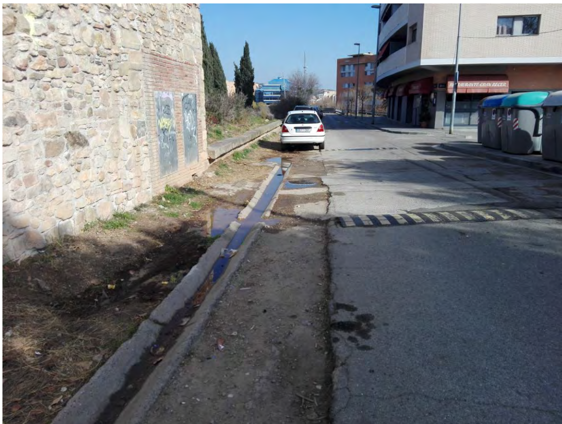
Estat de l'asfalt al tram proper a Can Bofi Vell
