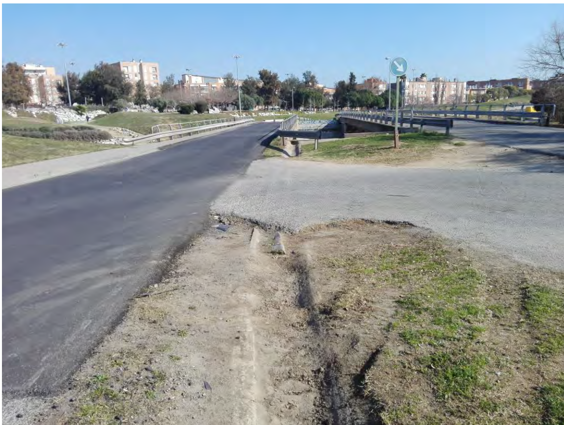
Estat de l'asfalt al tram d'intersecció amb el Parc del G5
