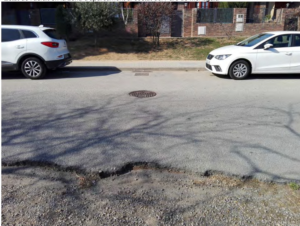
Estat de l'asfalt dels trams contigus a la mitjana
