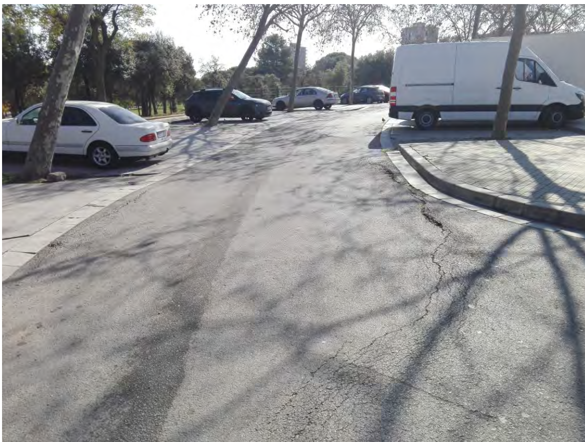
Estat de l'asfalt en la zona d'aparcament al costat del Parc de Montigalà
