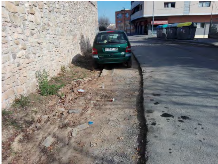
Estat de la calçada a l'alçada de Can Bofi Vell
