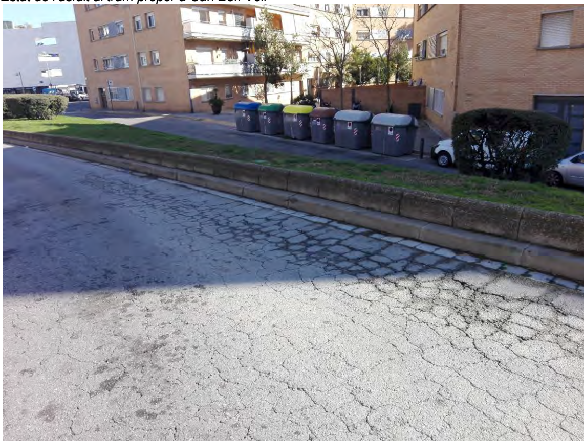
Estat de l'asfalt al tram proper al carrer de la Tècnica
