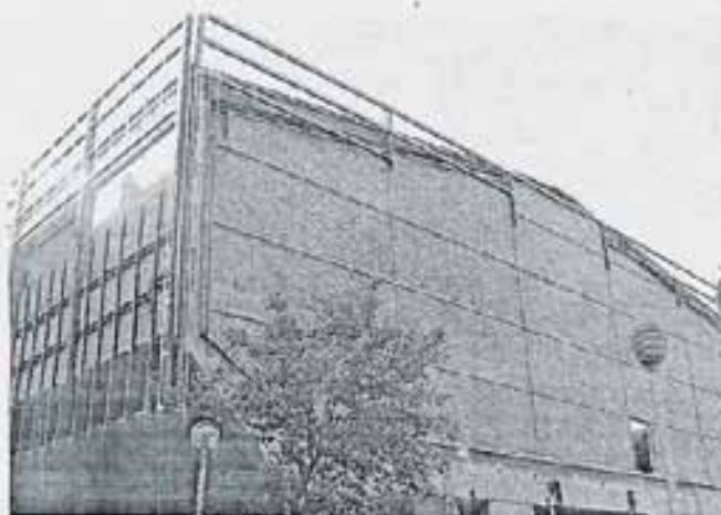
► Armadura per al Ricart. D'altra banda, la reforma del poliesportiu Ricart continua cadavent i des de fa uns dies es veu perfectament una estructura que cobreix la façana lateral i el sostre. Es tracta
